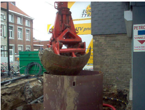
Verbuisd ontgraven maakt het mogelijk om tot grote diepte (tot 15 m-mv) te ontgraven naast bestaande constructies.
